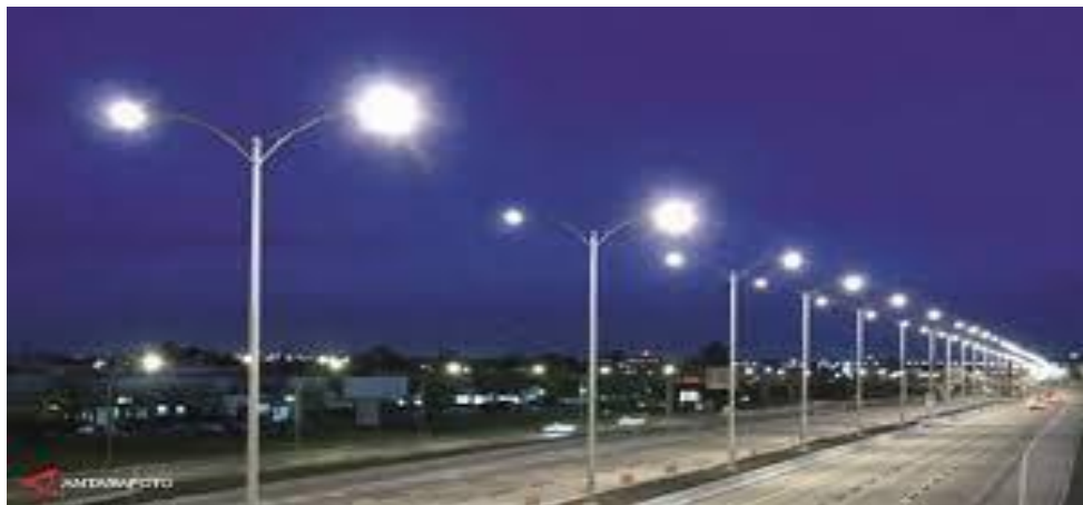
Gambar 12.6. Instalasi Penerangan Jalan Umum.
