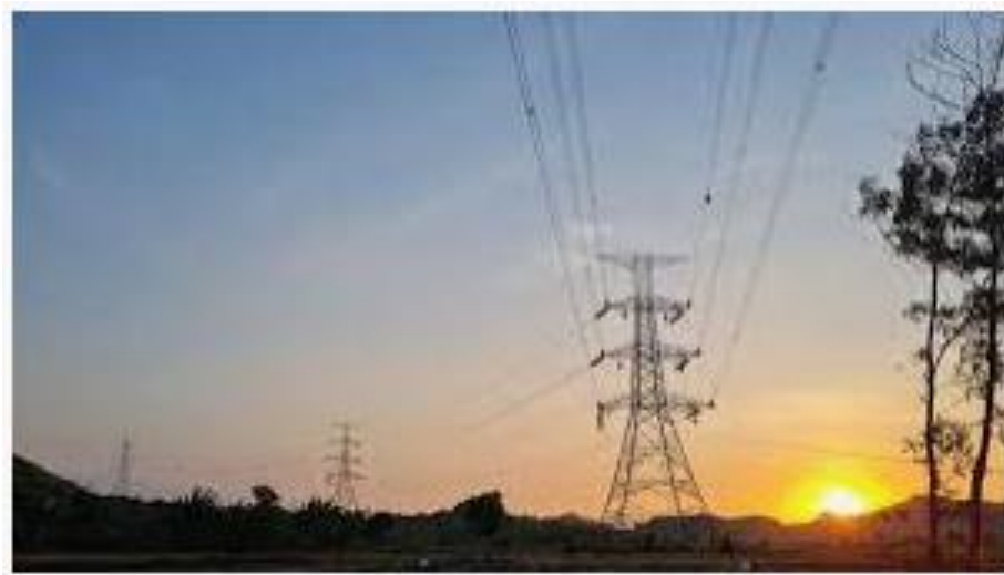
Gambar 1.6. Transisi Tegangan Tinggi
