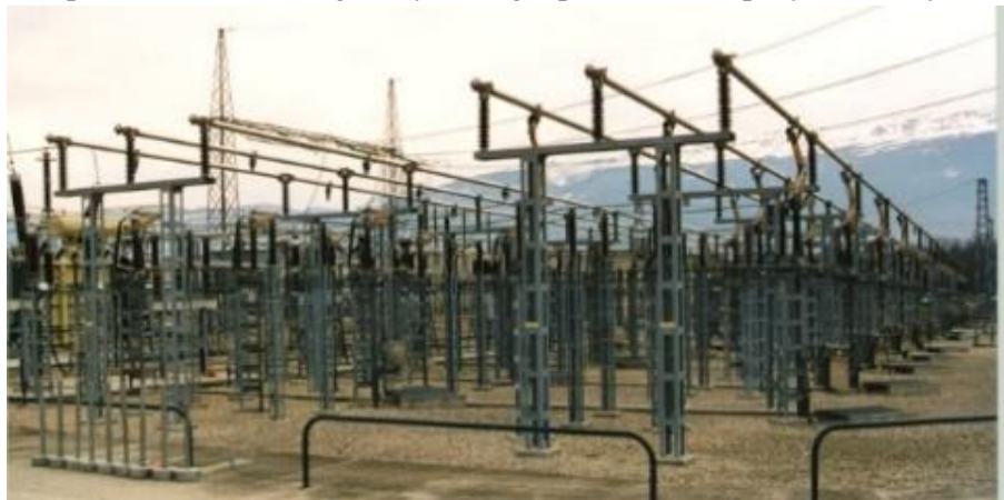
Gambar 10.11. Busbar Pada Gardu Induk
