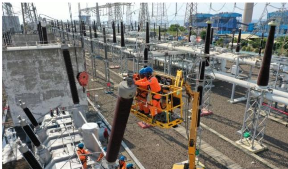
Gambar 10.12. Gardu Induk (GI) tegangan tinggi untuk konversi energi listrik dengan tegangan nominal 150 kv dan 70 kv.
