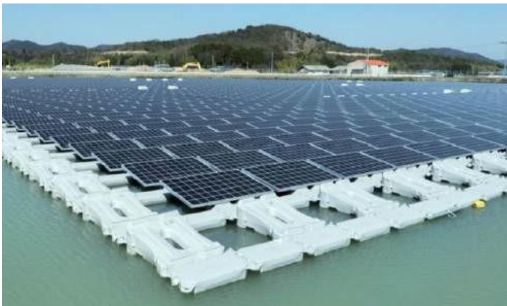
Gambar 4.3. Aplikasi Pembangkit Listrik Tenaga Surya (PLTS Cirata)
