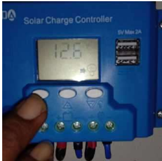
Gambar 3.11. Tegangan output SCC ke Arah Beban= 12,6 Volt
