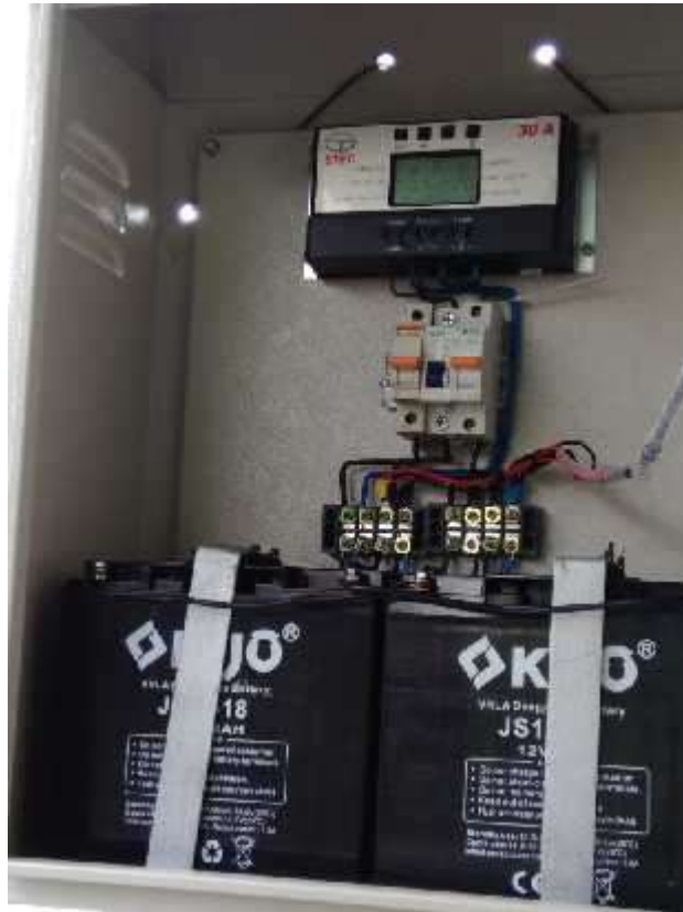
Gambar 3.7. Box Panel Kontrol Tampak Dalam
