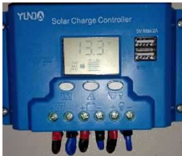
Gambar 3.9. Tegangan Pengisian ACCU dari PV = 13,3 Volt
